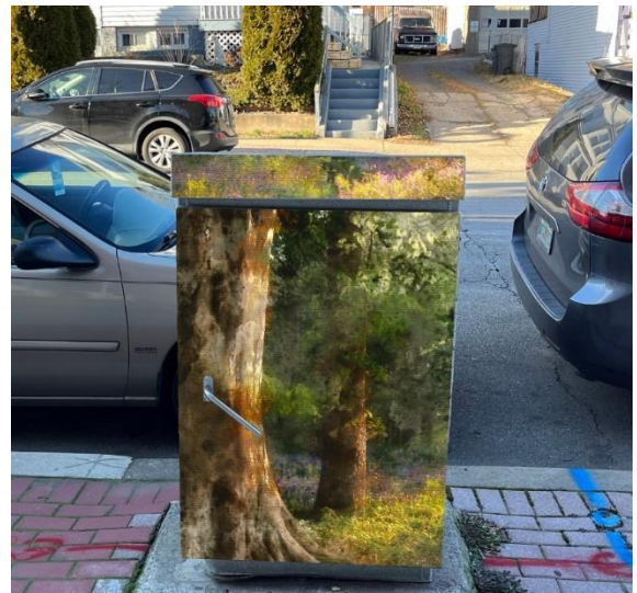
Imagen 13. El equipo del proyecto también presentó una opción para la decoración de los transformadores eléctricos.
